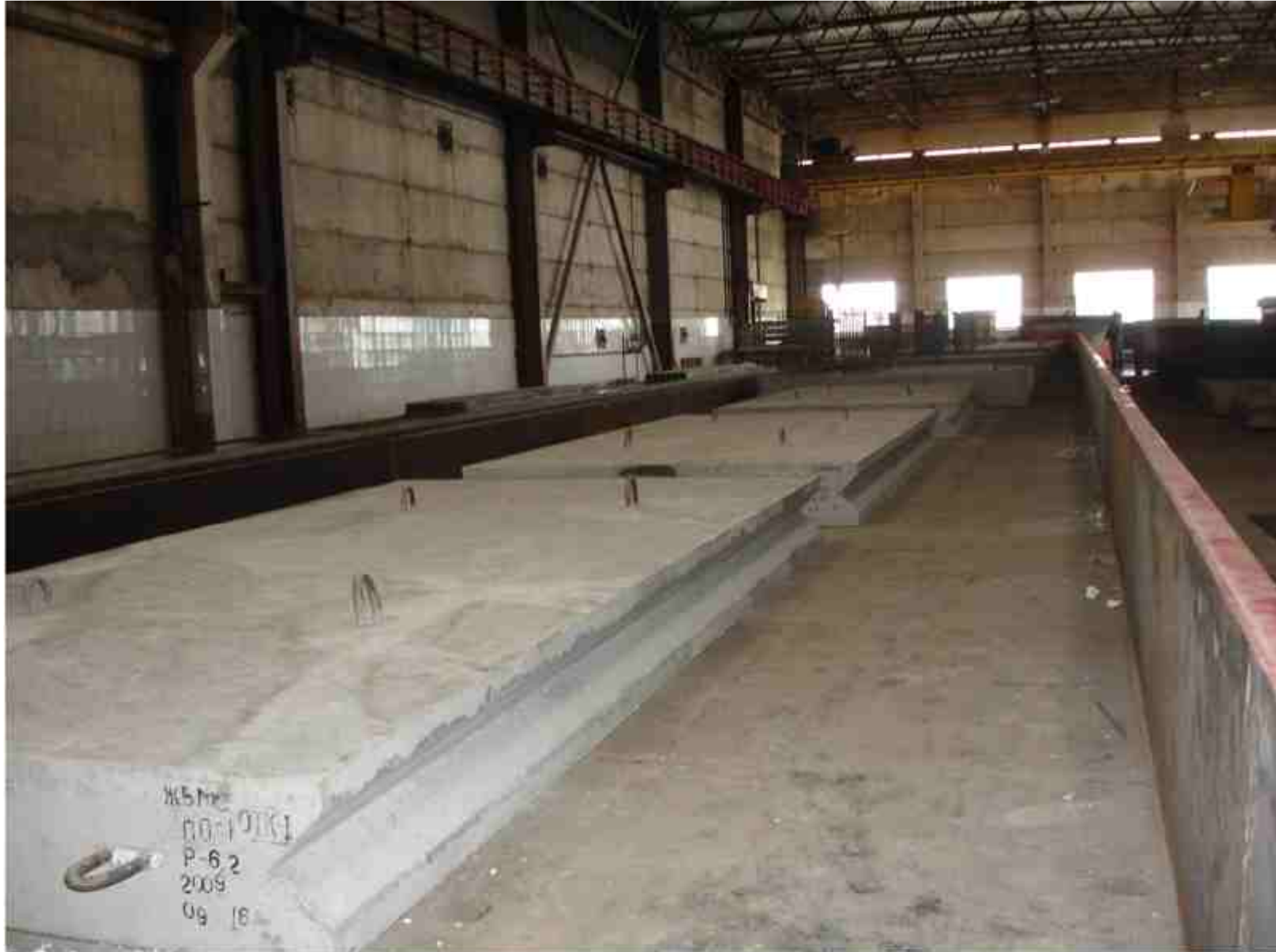
Изготовление сборных железобетонных конструкций промышленного назначения на универсальном стенде. ЗАО "Рекон" г. Чебоксары, 2009
