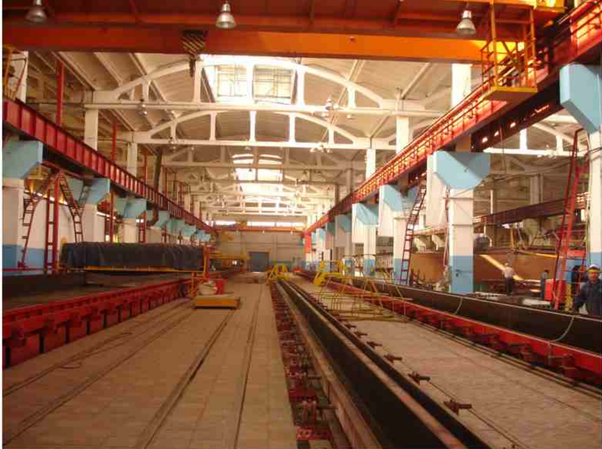
Завершение реконструкции завода ЖБИ с пуском в эксплуатацию технологических линий по выпуску конструкций сборно-монолитного каркаса. Линии ригелей, колонн. Универсальный стенд производственной мощностью 100 тыс. кв. м. каркаса зданий в год. Апрель, 2009, г. Красноярск
