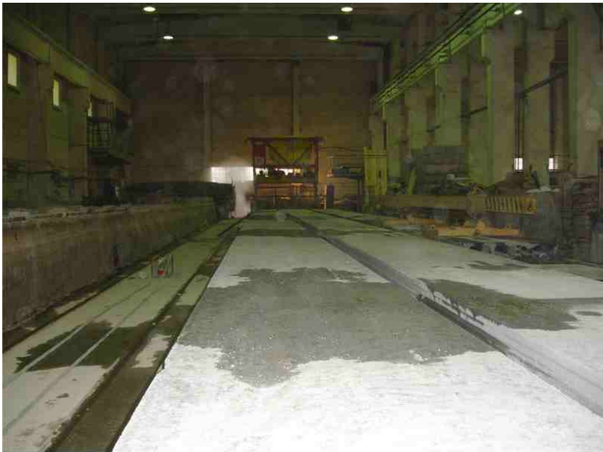
Универсальный станок оснащенный под выпуск пустотных плит в 3 нитки по ширине 1.2(м) Сентябрь 2009 г., Миасс. СМК-Каркас
